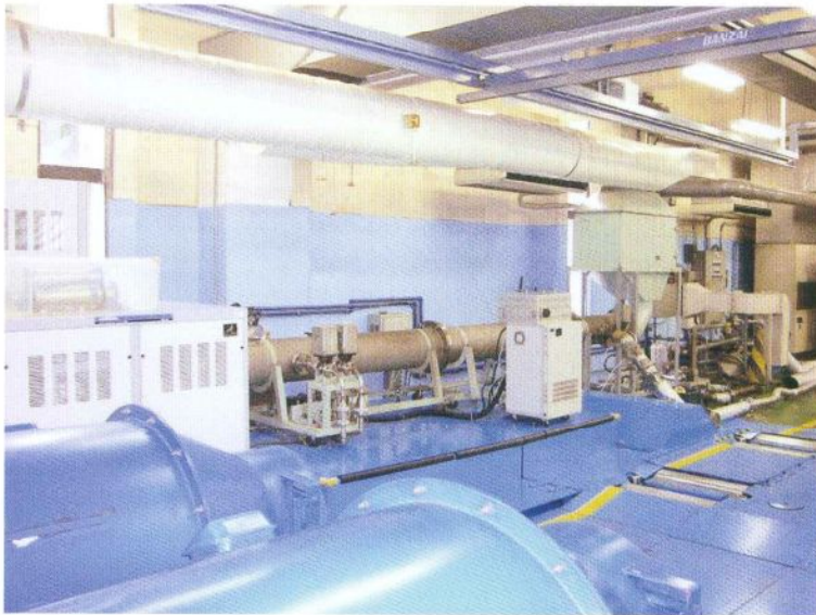
ダイリュージョントネル/シャシダイナモーター Dilution tunnel/chassis dynamo meter
